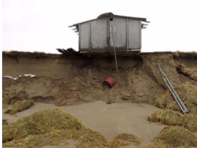
Figure 13. Infrastructure à risque en raison de l'érosion de la côte, Umiujaq, Nunavik, s.d. Photo de Antoine Boisson
